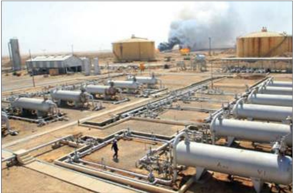
صورة رقم (١٤) أنابيب نقل النفط
